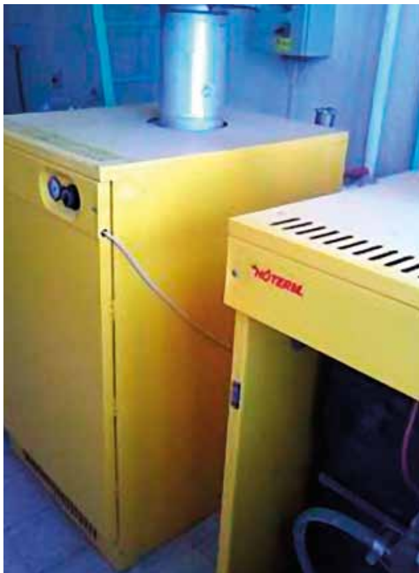
Kiváltásra kerülő gázkazánok a madarasi általános iskolában
