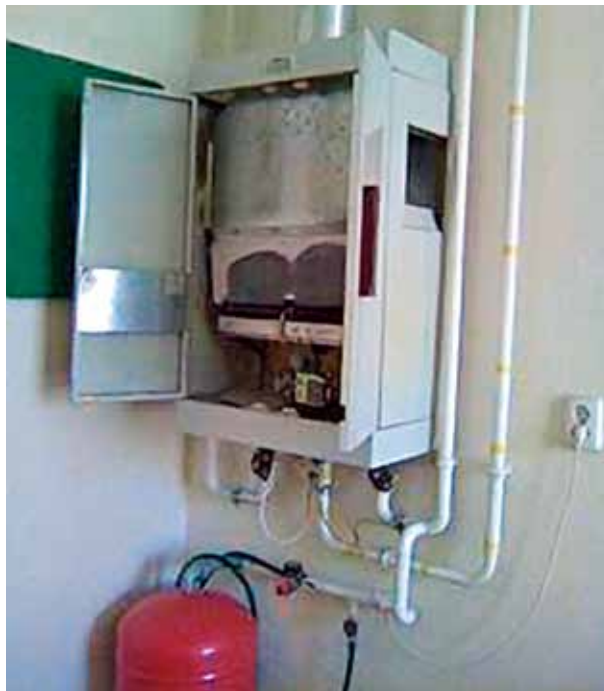
Kiváltásra kerülő gázkazánok a madarasi általános iskolában
