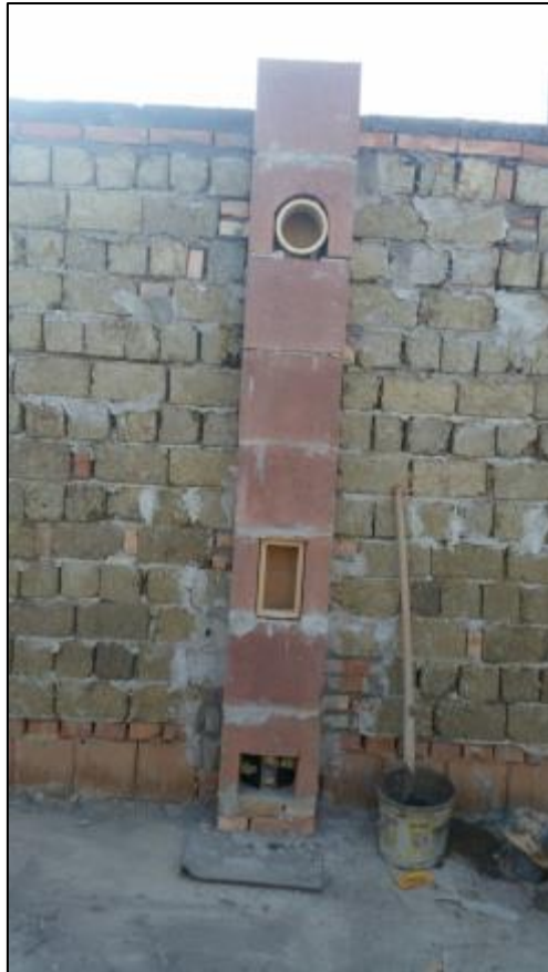
A kémények az előírásoknak megfelelő kerámiabetéttel, köpenycső falazással, hőszigeteléssel
